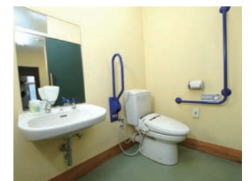
▲トイレは、車いすや手すりが必要な方に使いやすいバリアフリー設計。
